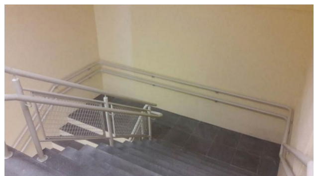
Figura 05 – Interior da saída de emergência do prédio Cotada Fonte: Autor (2018).
