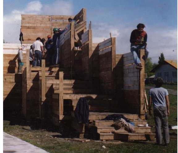
Obra de travessia em Puerto Guadal, região de Aysén, Chile. Autores: Ivan Ivelic, Mauricio Puentes, Jaime Reyes, Rodrigo Saavedra. Ateliê do Primeiro ano de Arquitetura. Escola de Arquitetura e Design PUC-Valparaíso, 2004. Arquivo fotográfico José Vial Amstrong. Escola de Arquitetura e Design, PUC-Valparaíso.
