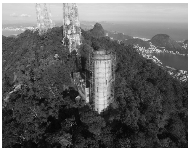
Figura 6. Vista aérea do processo de arruinamento da torre, 2016.
