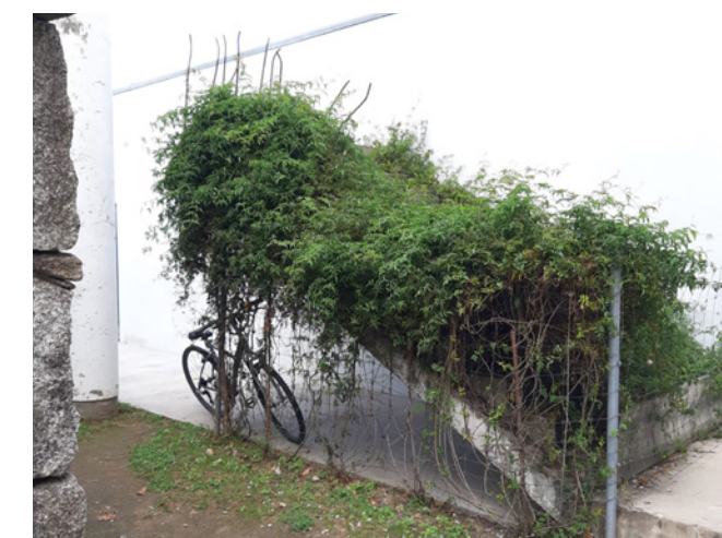
Figura 11. Escada remanescente da intervenção anterior coberta por vegetação, 2019.
