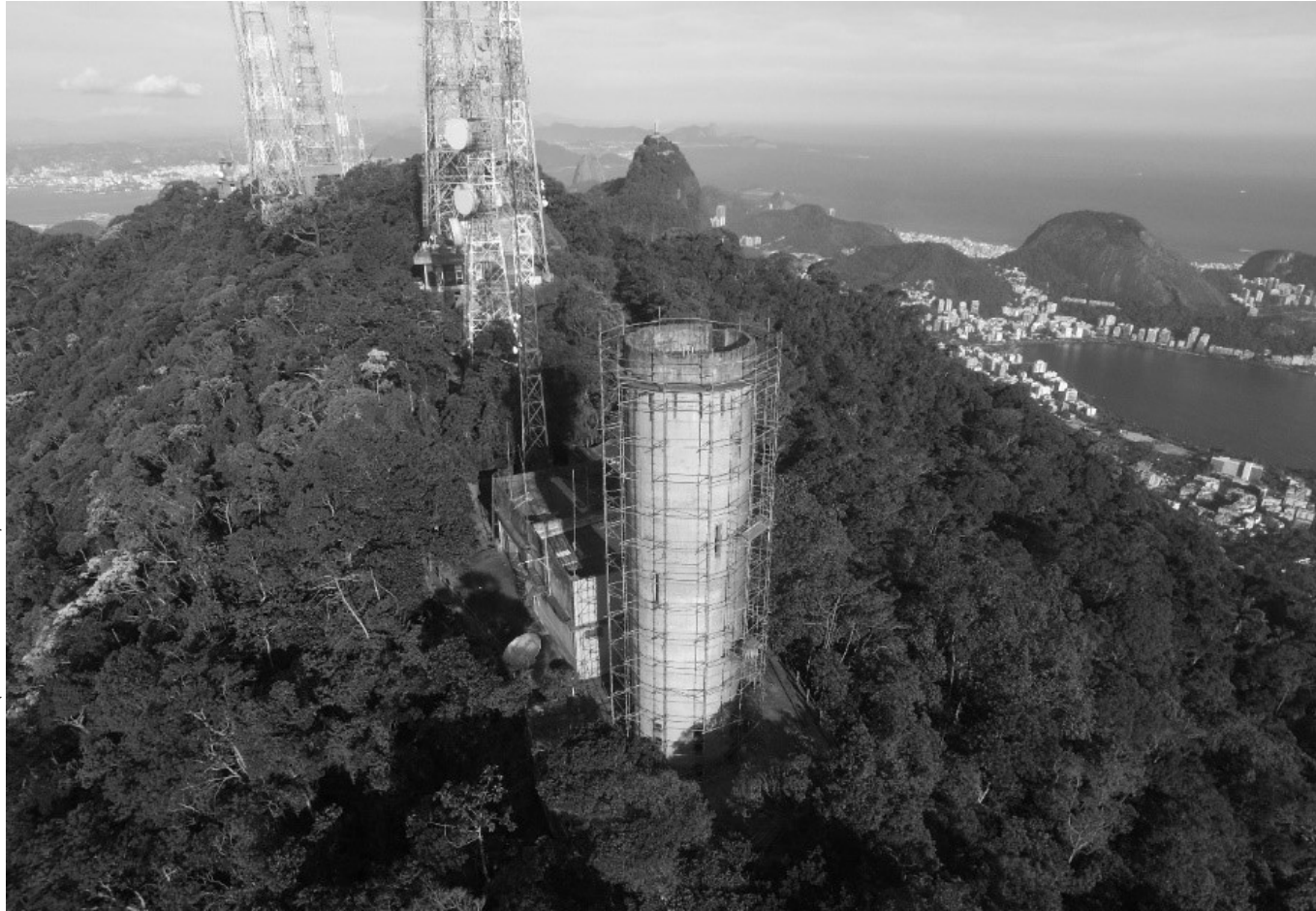
Figura 6. Vista aérea do processo de arruinamento da torre, 2016.
